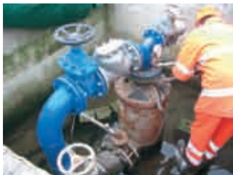
A destra tubature di presa di un pozzo in località Mantovane
